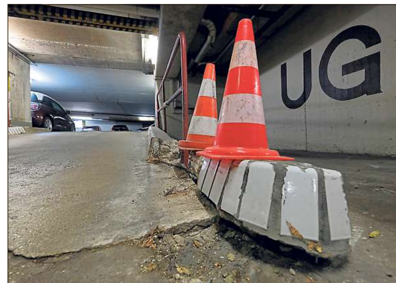
An zahlreiche Ecken bröseln die Gebäudesubstanz des Parkhauses vor sich hin.
