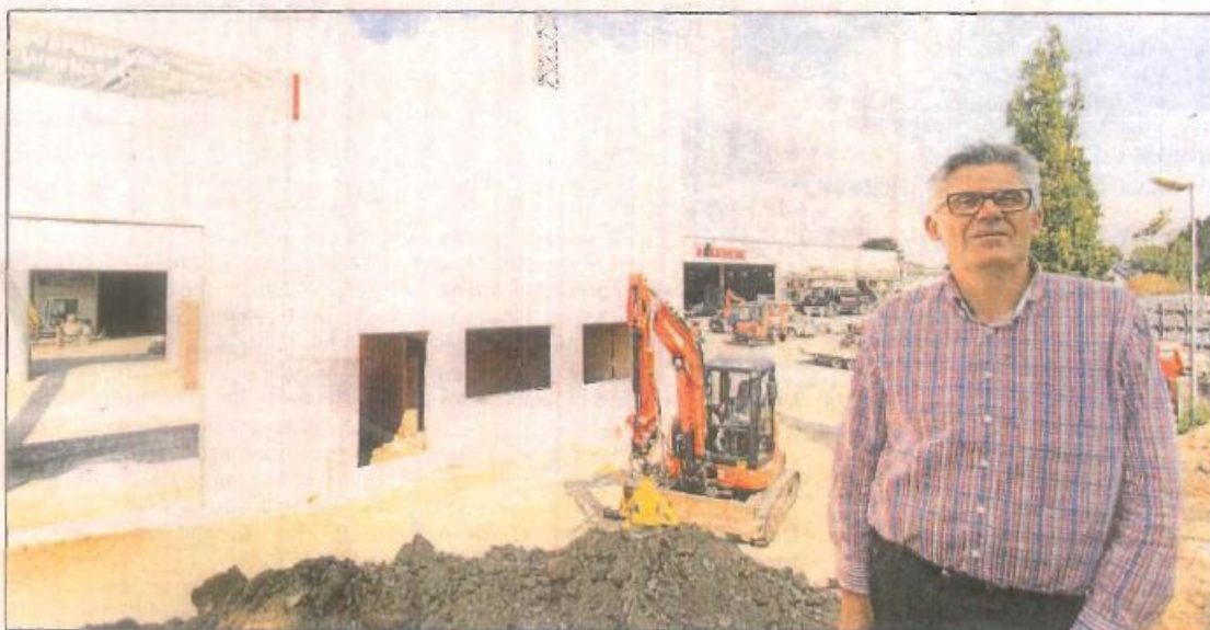
Am Sitz der Firma Kuhn lässt Geschäftsführer Burkhard Kuhn eine neue Werkstatthalle bauen. Dort will der Unternehmer demnächst Baumaschinen für seine Kunden reparieren lassen. Foto: Mukherjee
